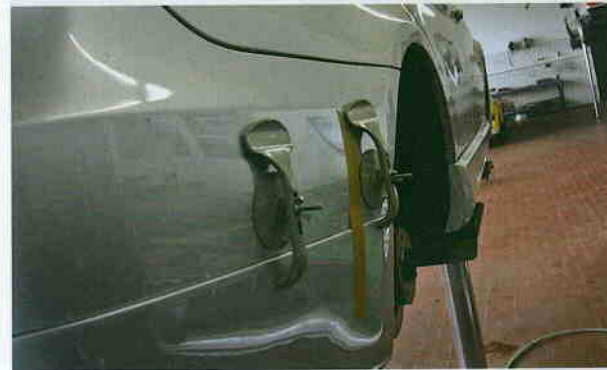
Spezielle Montagehilfen mit Saugnäpfen halten die Schürze fest gegen die Stoßstange gedrückt, während der Kleber anzieht.
